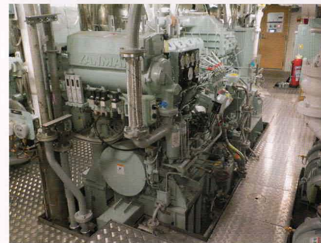
主発電機関 Main generator engine
