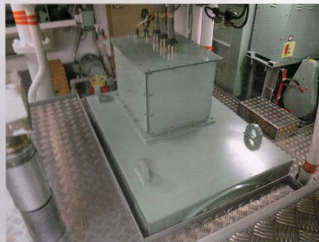
軸発電機 Shaft generator
